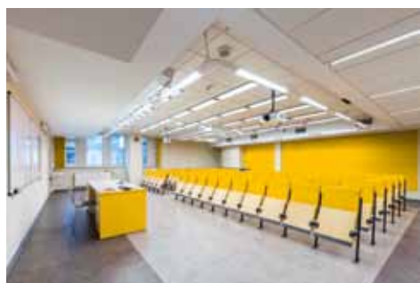
In einen modernen Hörsaal baut Avitel sieben verschiedene Audio- und Videosysteme ein.
